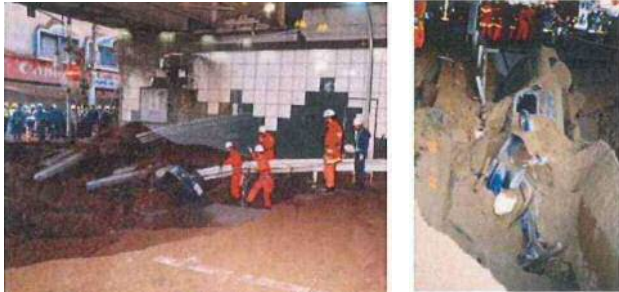
原因 薬液注入による数量のごまかし、手抜き工事
