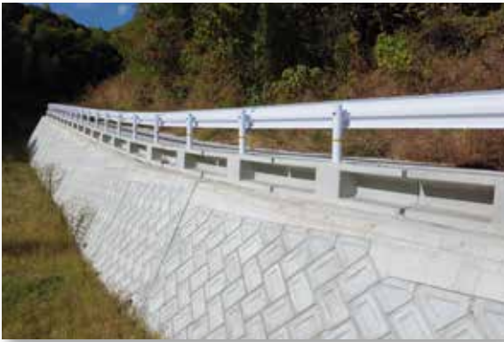
■その他水系東五反田川隣災害関連緊急砂防事業に伴う業務委託 ■ 広島県 東部建設事務所 三原支所 (T型・間知ブロック)
