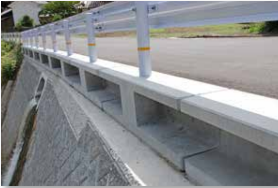
■二級河川沼田川水系管川砂防設備災害復旧工事 (平成30年災害第258号) ■ 広島県 東部建設事務所 三原支所 (T型・スプリット21)
